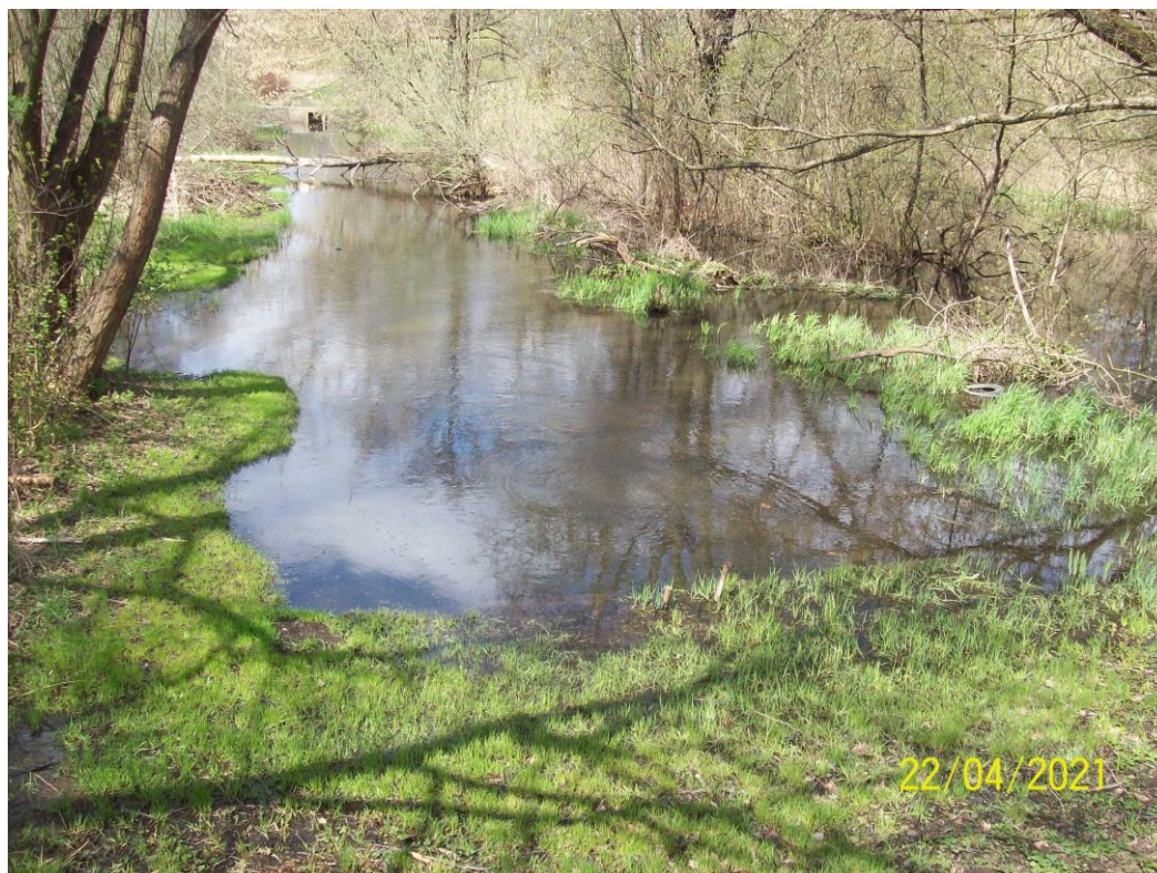
Fot. 4.5 Wylot przepustu rurowego 1P, całkowicie zatopiony przyczółek
