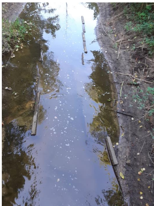
Fot. 4.12 Zniszczone umocnienia koryta za wylotem mnisza 6MN do Utraty
