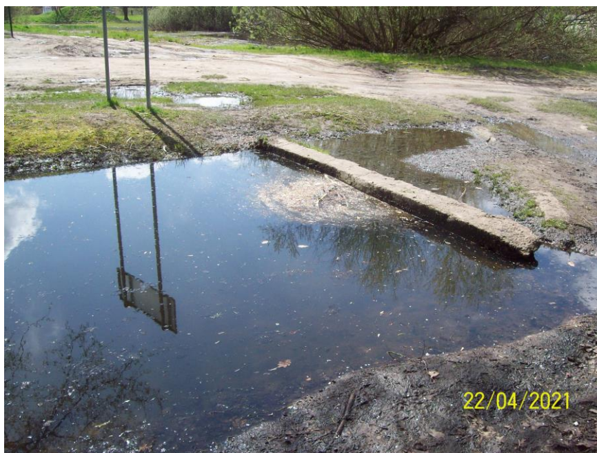
Fot. 4.4 Wlot przepustu rurowego 1P, rozmyty prawy brzeg przy przyczółku
