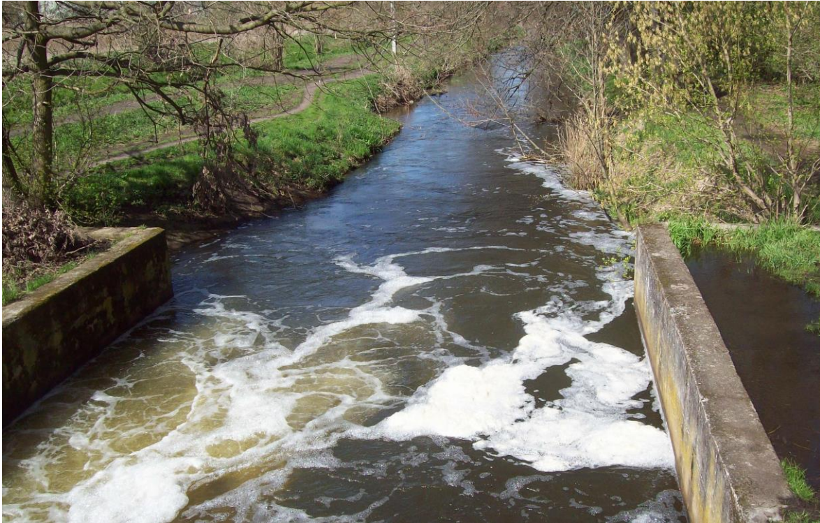
Fot. 4.2 Widok na wypad jazu z kładki – z prawej strony woda na powierzchni terenu wzdłuż ściany prawego przyczółka
